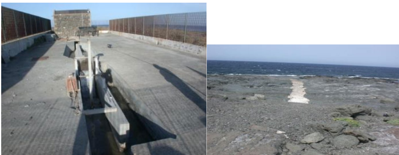
Depuratore attuale all'Arenella
